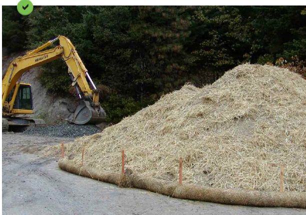
Couverture du dépôt provisoire à l'aide d'un paillage par mulch et contrôle du périmètre à l'aide d'un boudin de rétention.
