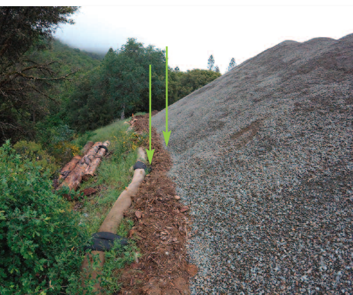
Contrôle du périmètre coté bas d'un dépôt provisoire à l'aide d'un merlon de copeaux de bois et d'un boudin de rétention.
